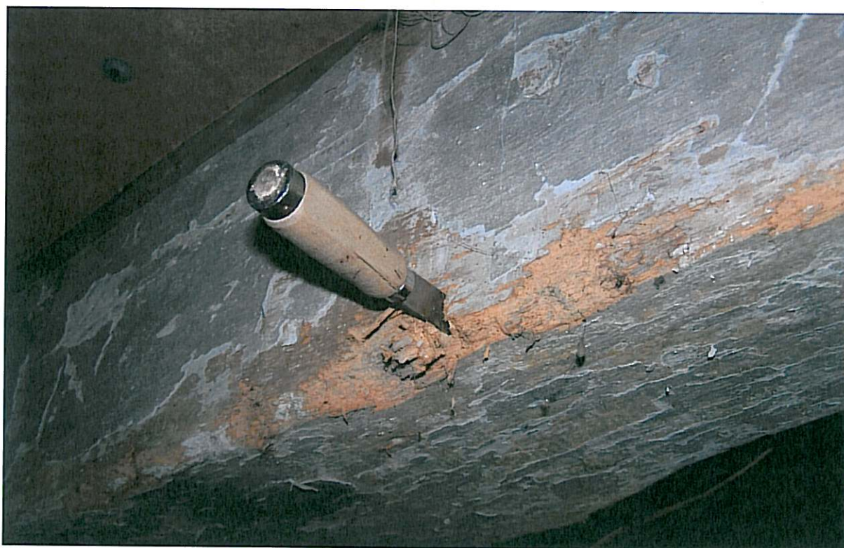
Fotografia nr 18. Belka stropowa w pomieszczeniu nr U/2 załącznik nr 1.
