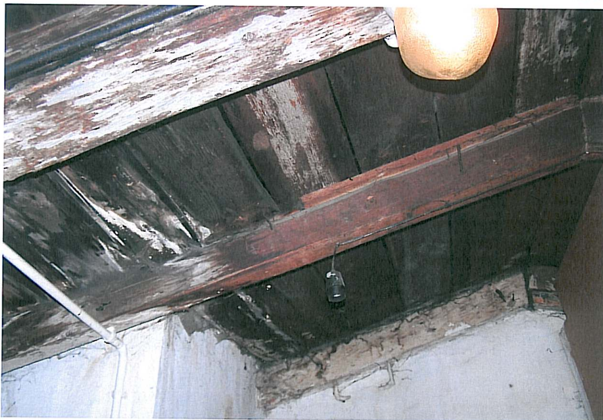
Fotografia nr 13. Zagrzybienia na poddaszu. Widok w kierunku zachodnim.
