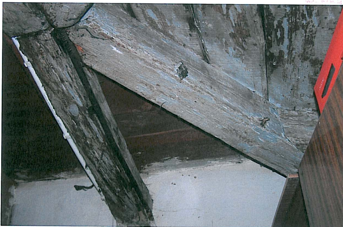
Fotografia nr 17. Zagrzybienia na poddaszu. Widok w kierunku południowo wschodnim.
