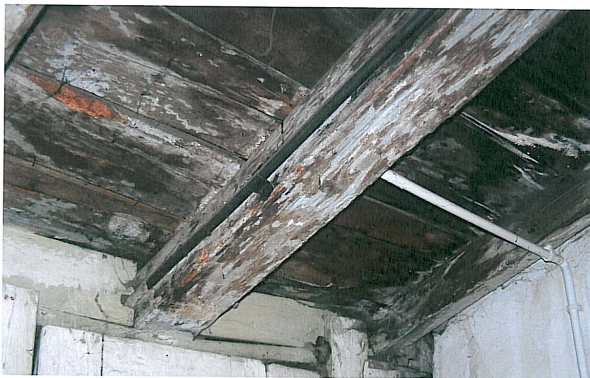
Fotografia nr 14. Zagrzybienia na poddaszu. Widok w kierunku wschodnim.
