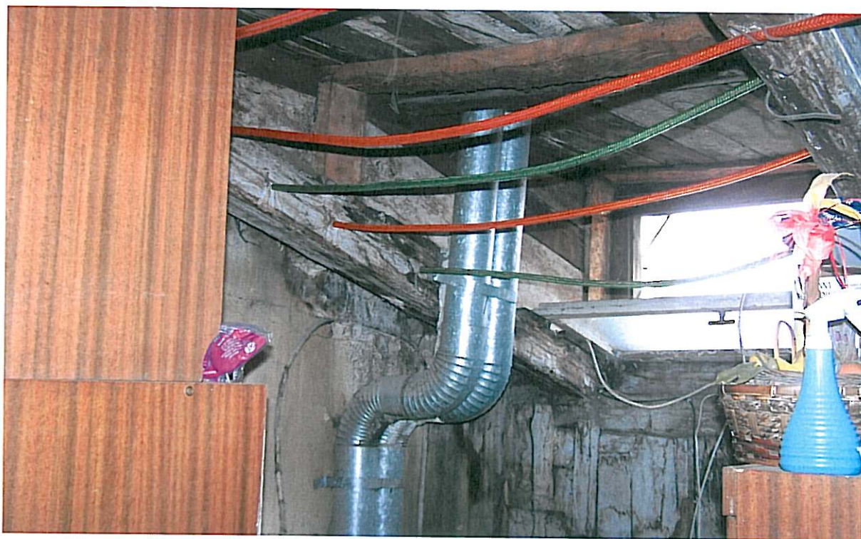
Fotografia nr 16. Zagrzybienia na poddaszu. Widok w kierunku południowo wschodnim.
