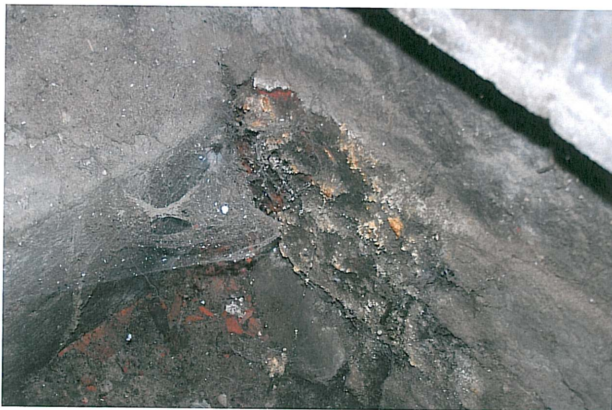
Fotografia nr 20. Zawilgocenie i zagrzybienie pomieszczenia U/2 w zał. nr 1.
