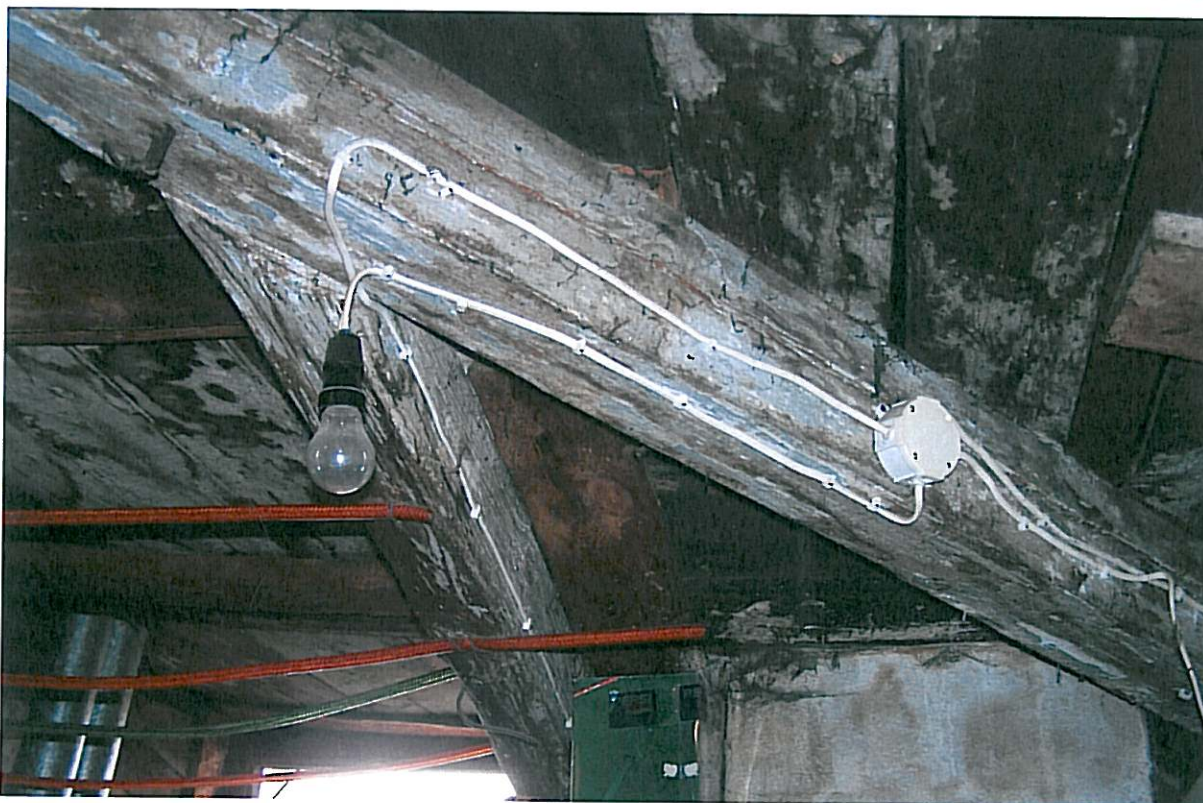
Fotografia nr 15. Zagrzybienia na poddaszu. Widok w kierunku południowo zachodnim.
